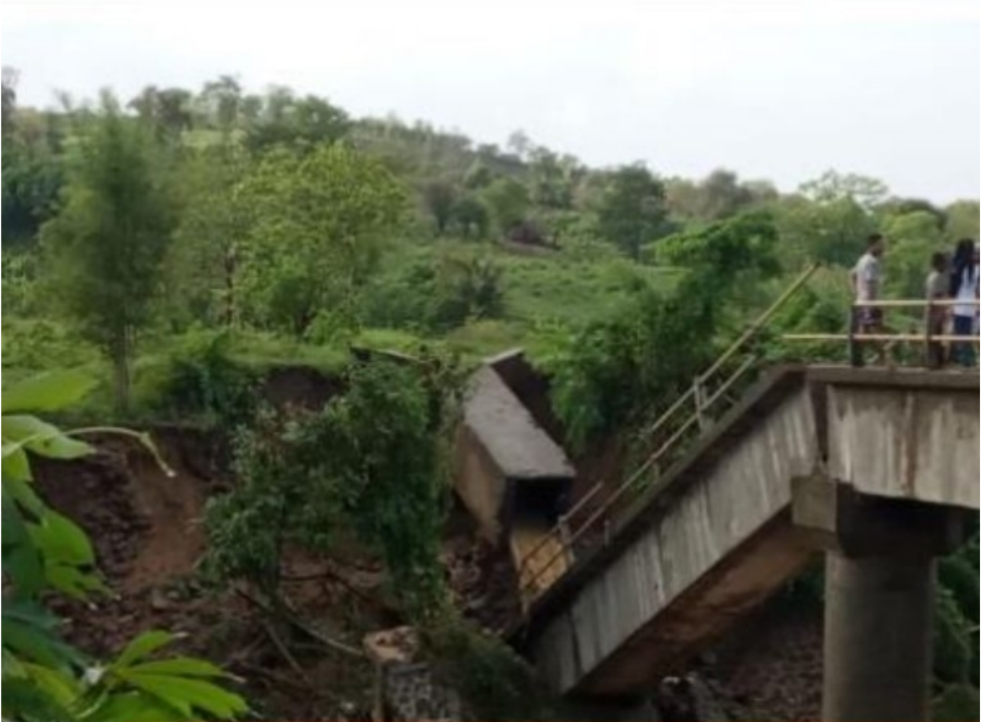
Jembatan Roboh akibat Banjir Bandeng di Lunyuk, Sumbawa, (09/10)
